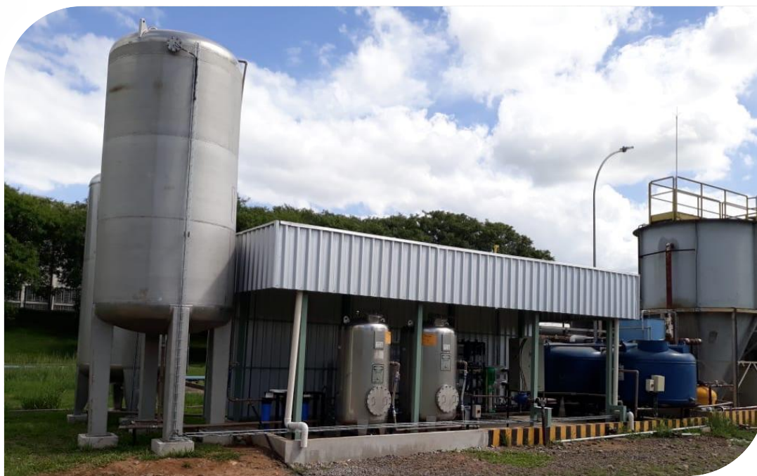
Planta de osmose reversa.
